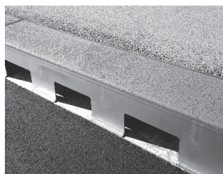
写真3 滑り止め塗装と側面開口
